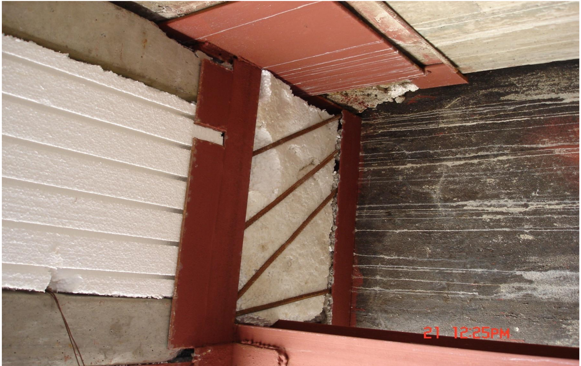
اتصال غیر اصولی سازه فلزی و بتنی
