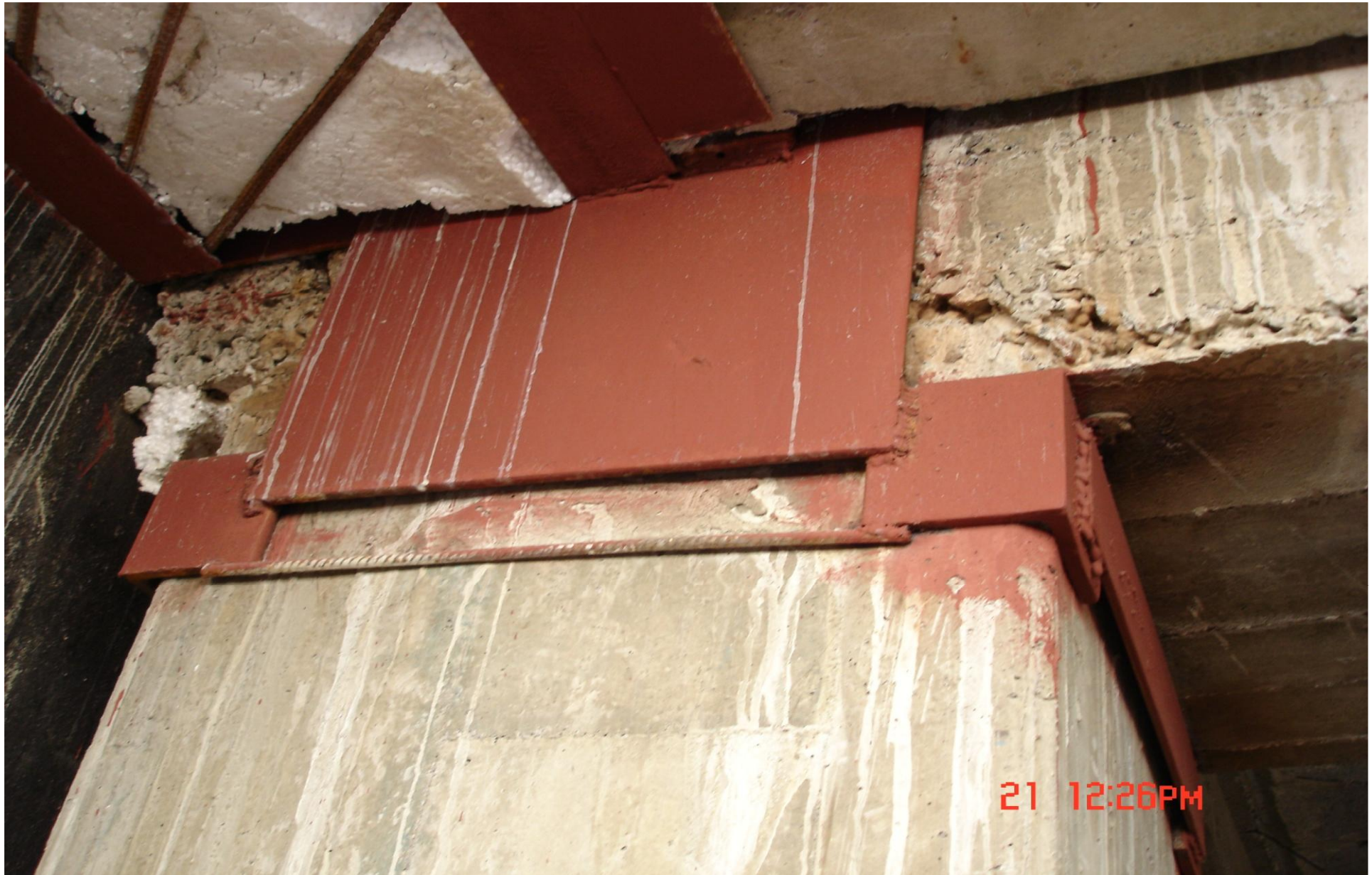
اتصال غیر اصولی سازه فلزی و بتنی
