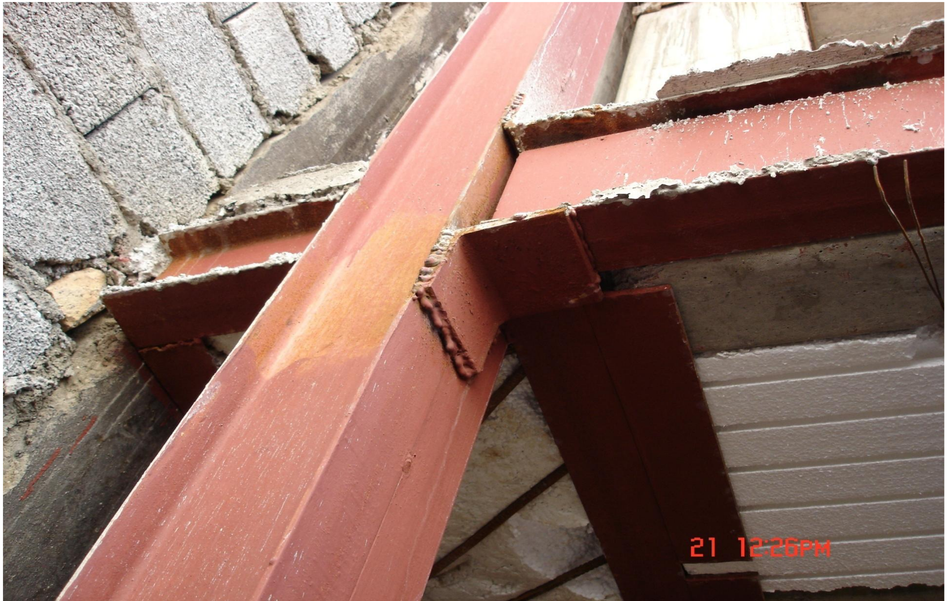
اتصال غیر اصولی سازه فلزی و بتنی
