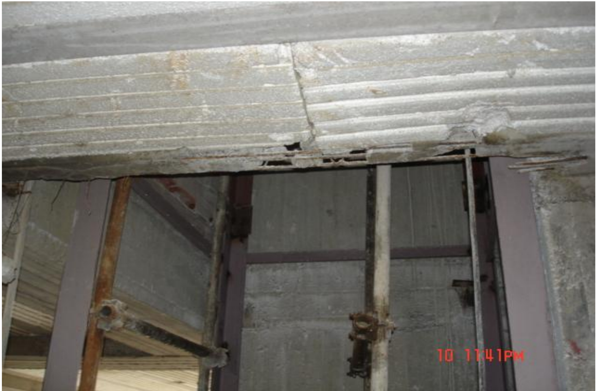
تخریب تیرچه در محل بازشو آسانسور
