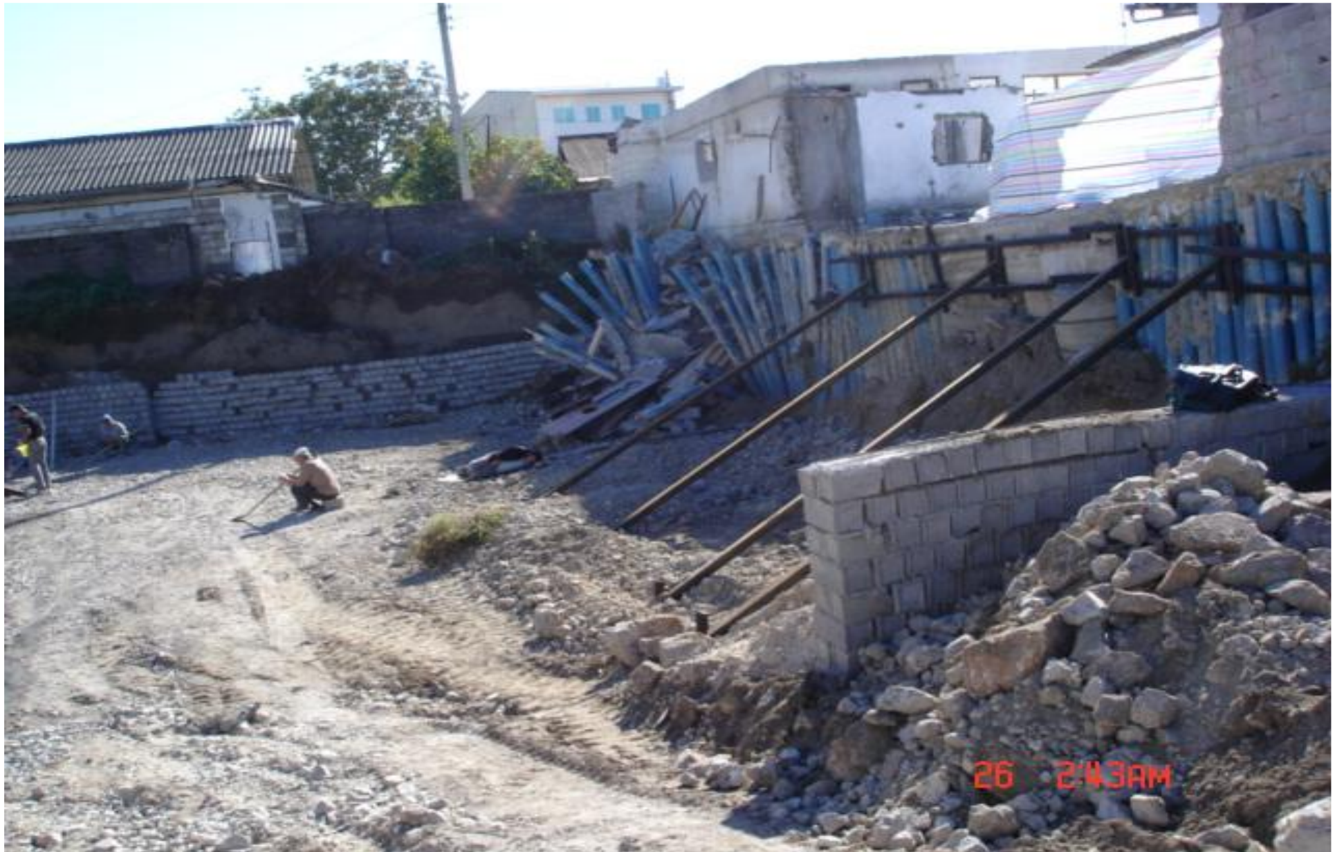
عدم اجرای اصولی سازه نگهبان و تخریب ساختمان مجاور
