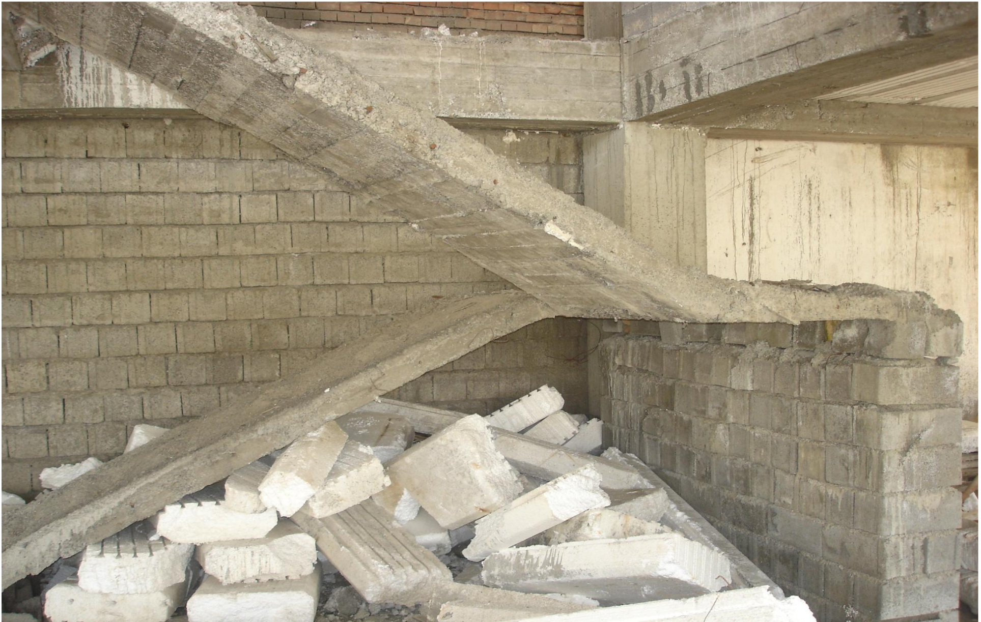
عدم اتصال پله به ستون در محل پاگرد نیم طبقه
