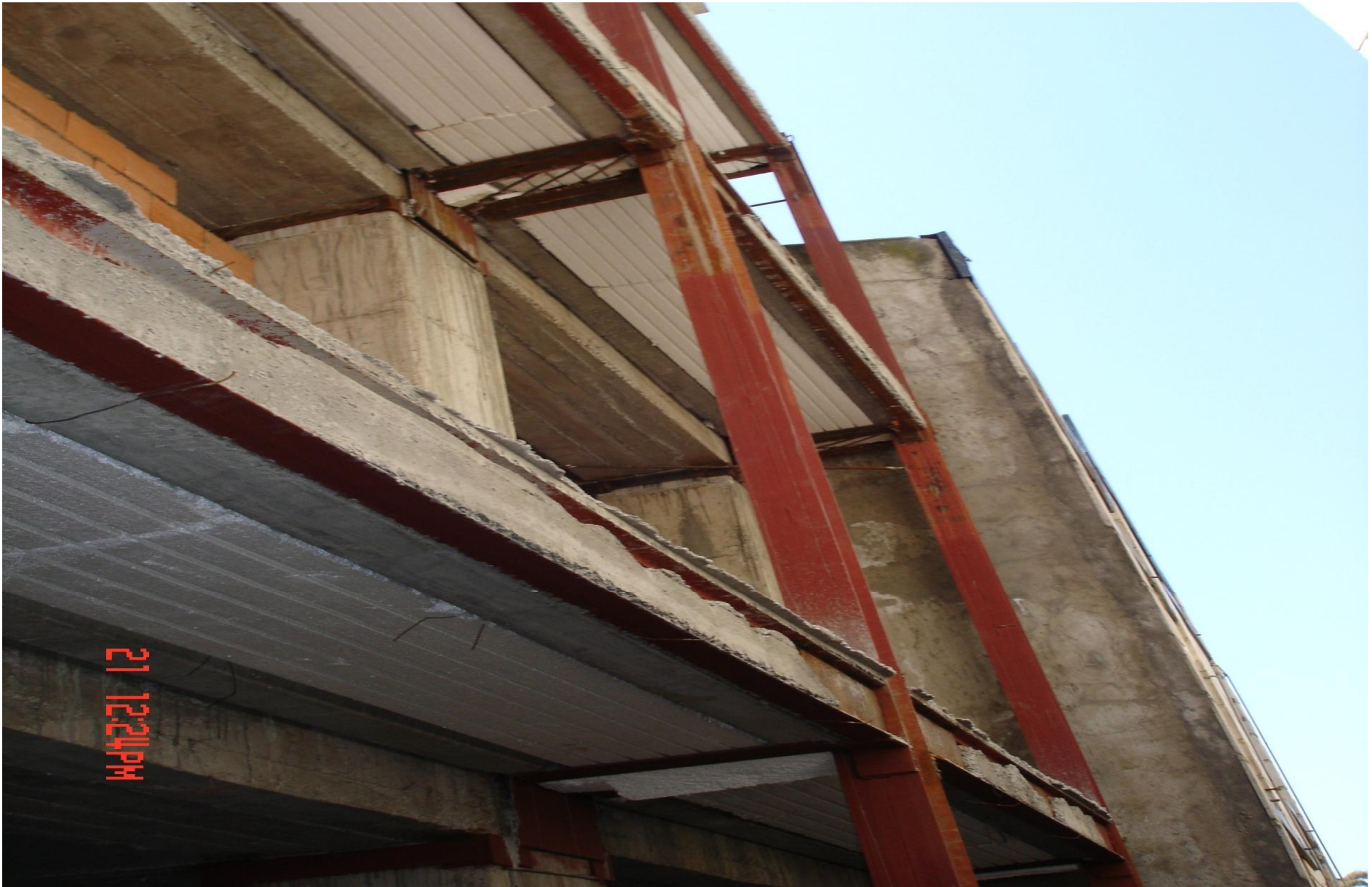
اتصال غیر اصولی سازه فلزی و بتنی
