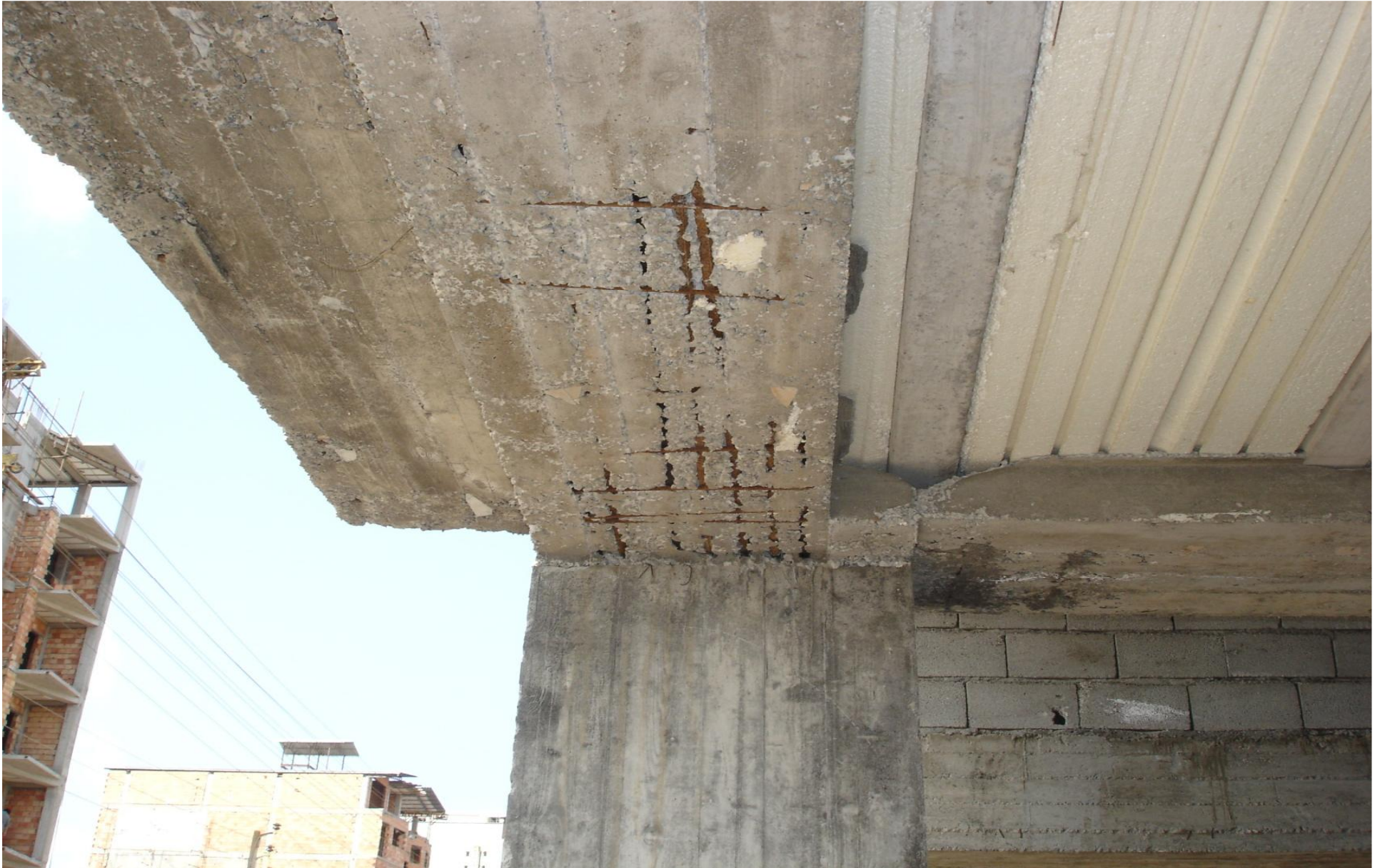
پوشش نامناسب بتن
